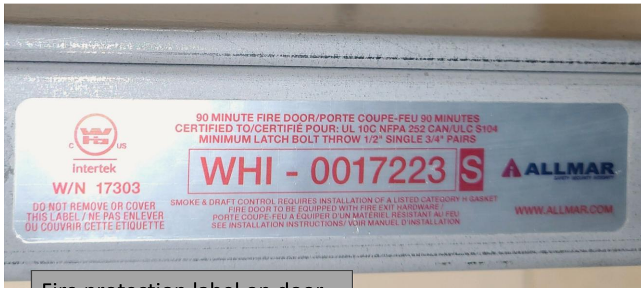
Fire protection label on door
