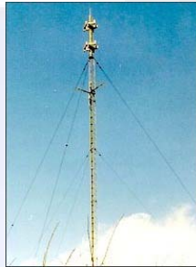
Example of a MET tower
